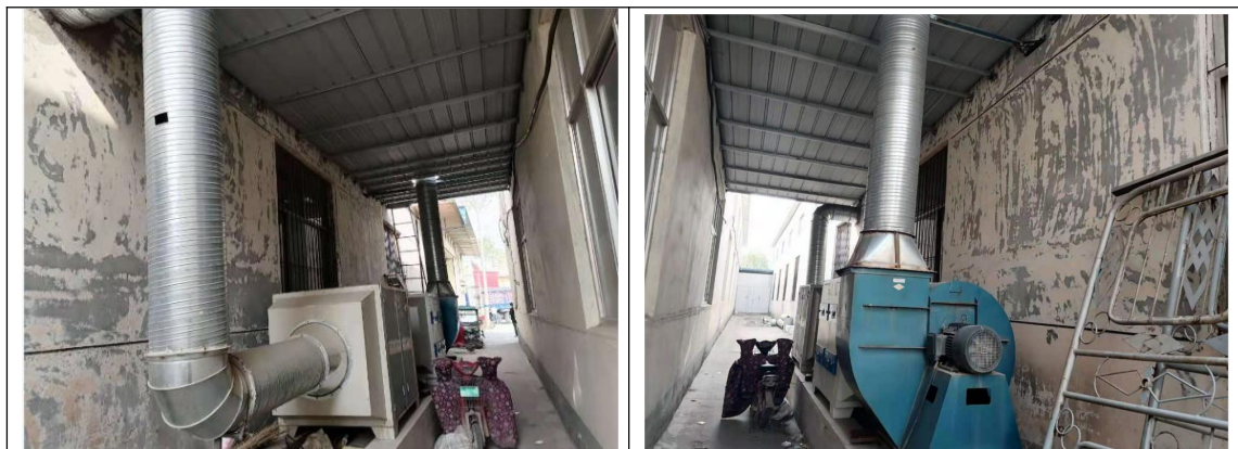
图 3-1 废气处理设施
