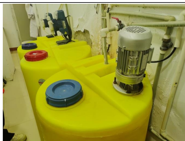
污水处理站加药间
