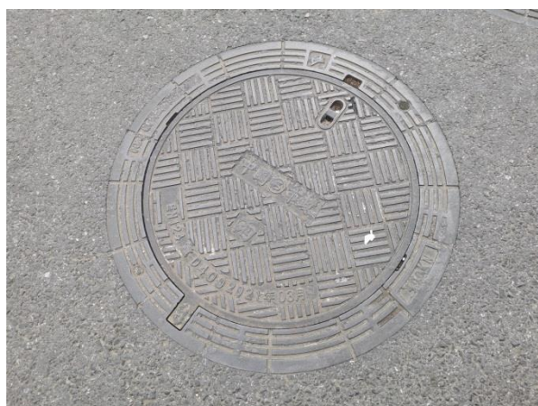
项目接入的市政雨水管网
