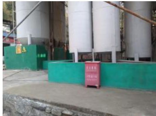
灭火器及围堰
