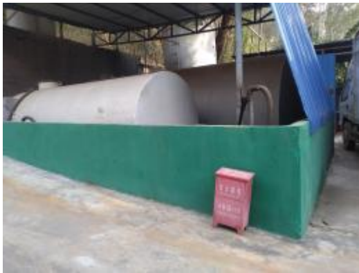
灭火器及围堰
