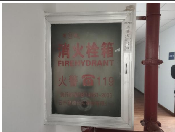
二十九、消防栓箱
