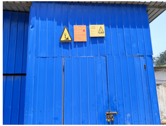
九、危险废物暂存间
