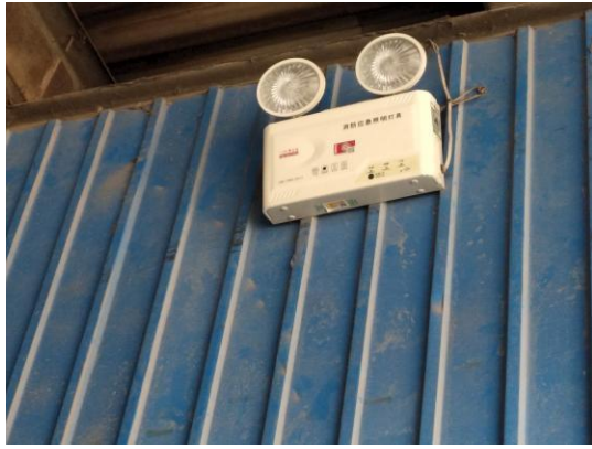
十七、应急照明灯
