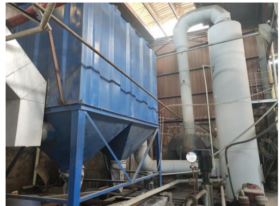
二十二、EPS 脱硫除尘器
