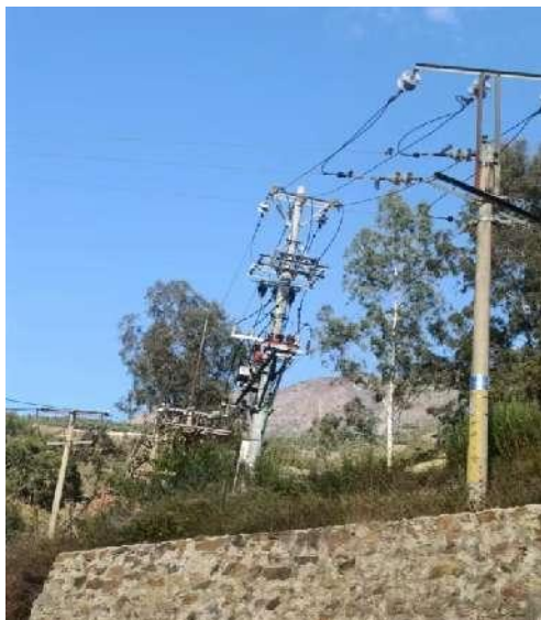
厂区供电线路
