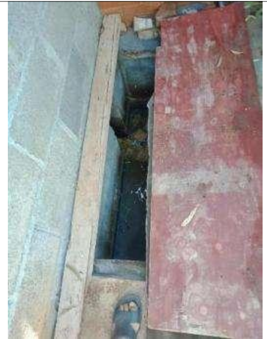
生活废水沉淀池
