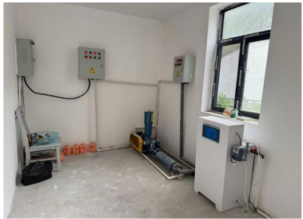
污水处理设施
