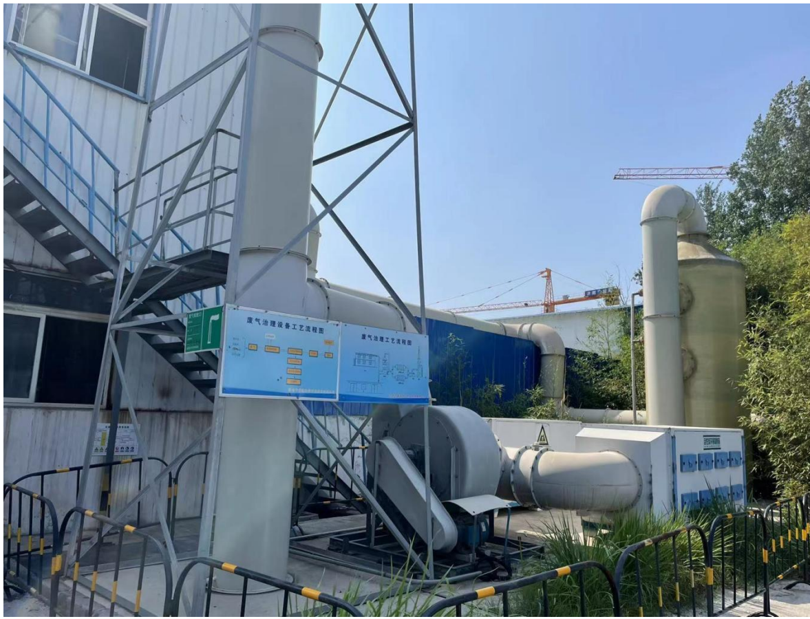
图7-1 废气处理设备
