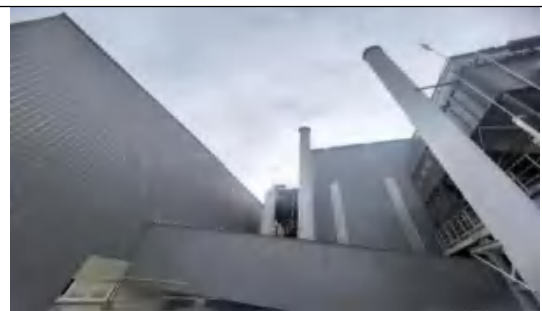
二筛布袋除尘器及排气筒
