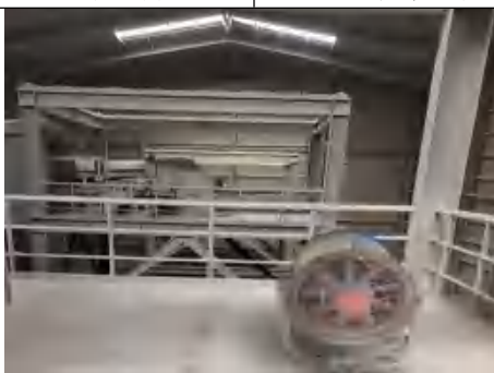
产品库洒水抑尘装置
