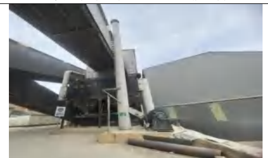
土筛布袋除尘器及排气筒
