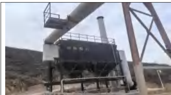
给料机布袋除尘器及排气筒
