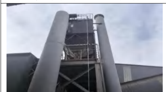
制砂机布袋除尘器及排气筒
