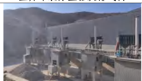
装车楼布袋除尘器及排气筒
