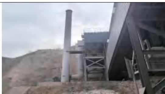
破碎机布袋除尘器及排气筒
