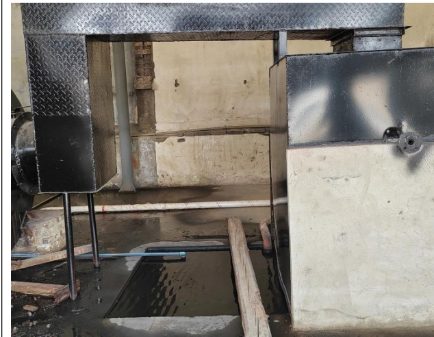
照片 3：锅炉水膜除尘设施
