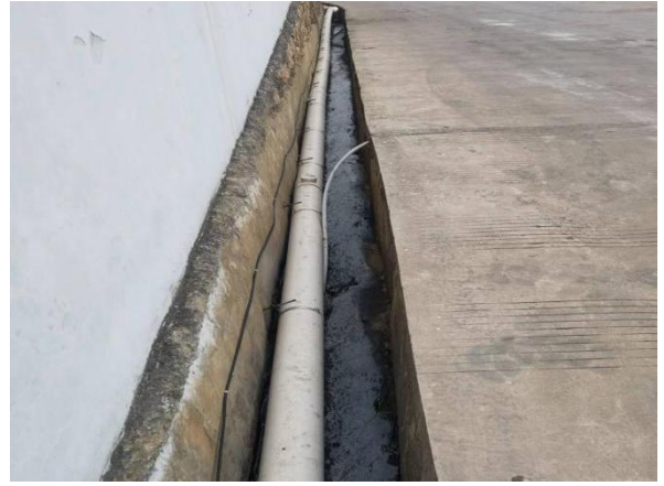
照片 8：博杰园区生活污水收集管
