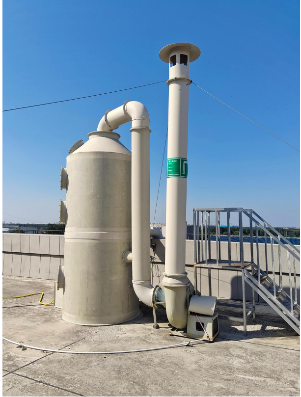
图7-1 废气处理设备
