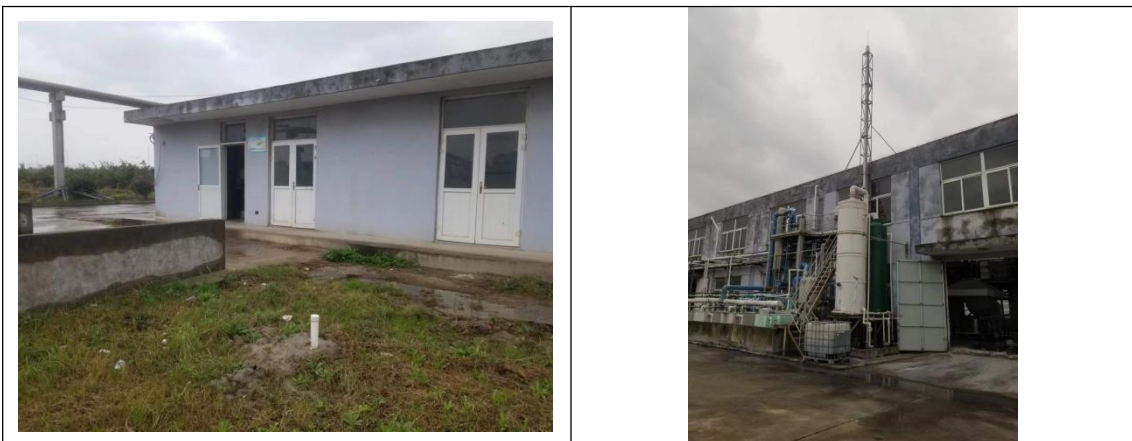
三废处理区：废水处理设施在线监控设备，监测小屋，废气处理设施已设置围堰，地面完好无明显破损裂痕。
