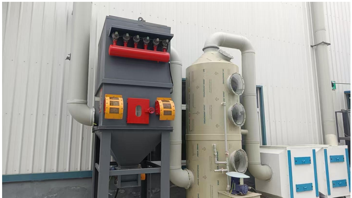
图7-1 废气处理设备
