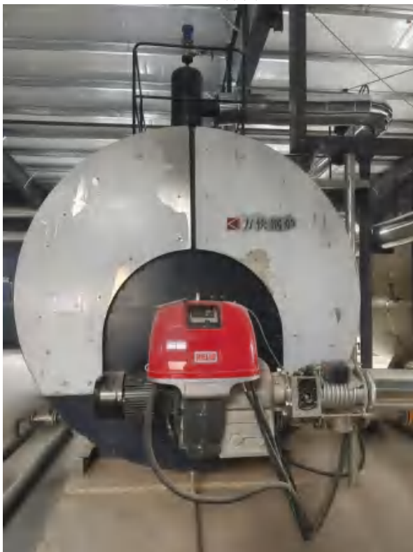
DA008 2#4.2MW燃气锅炉低氮燃烧器
