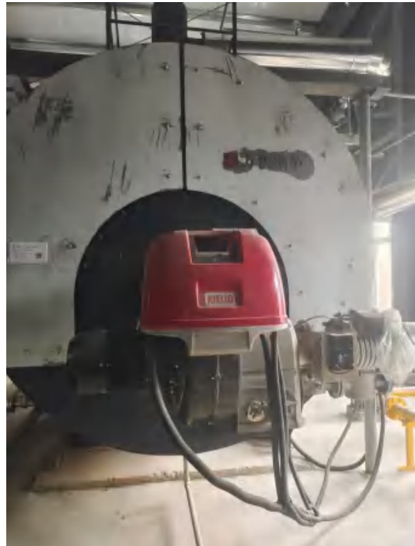
DA007 1#4.2MW燃气锅炉低氮燃烧器
