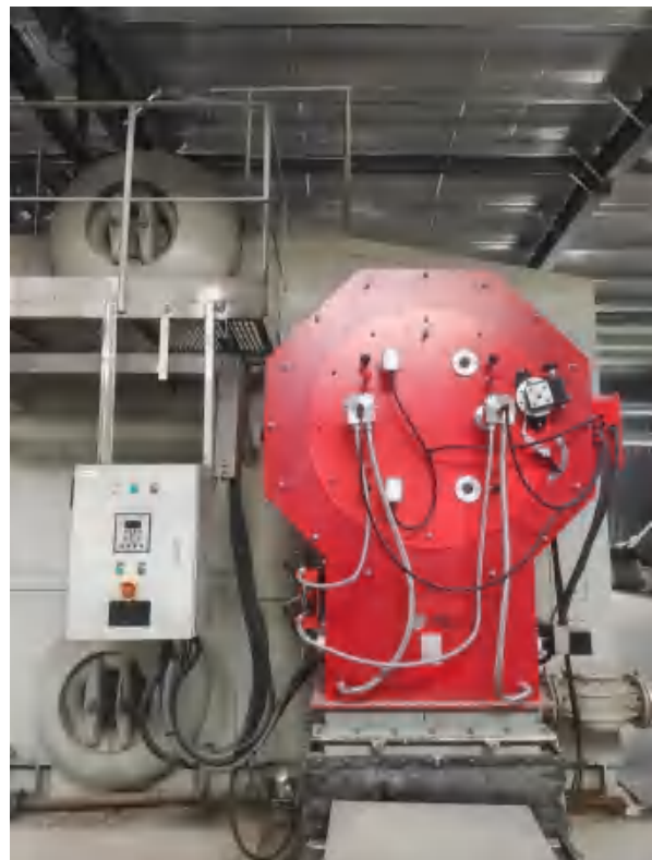
DA009 29MW燃气锅炉低氮燃烧器
