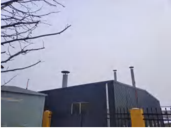
三个燃气锅炉排气筒
