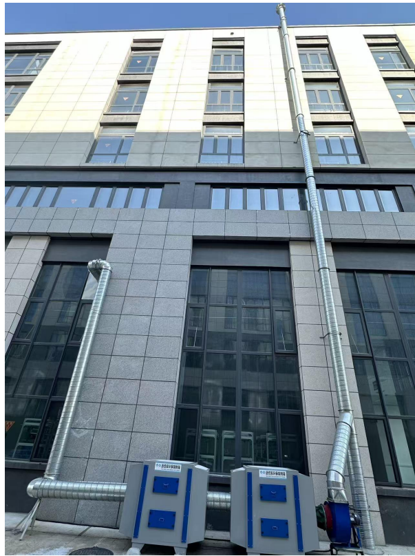
图7-1 废气处理设备
