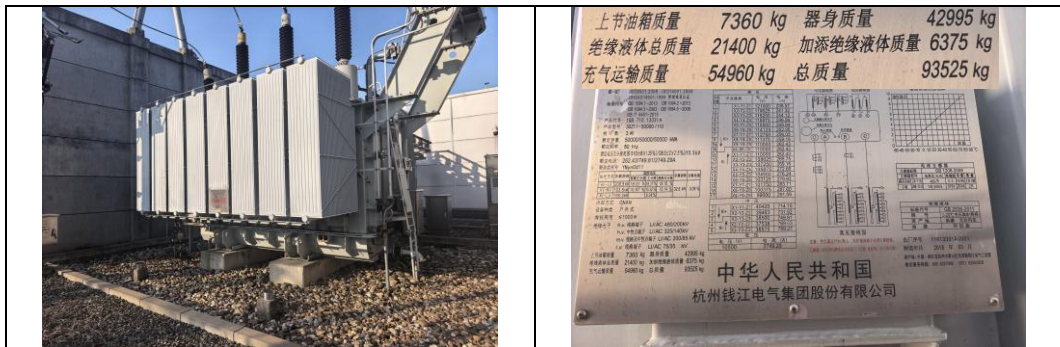
1 号主变及油坑
