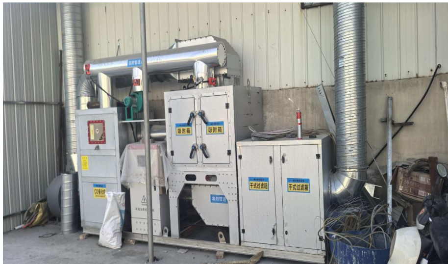
“干式过滤+活性炭吸附+脱附+CO 催化燃烧”装置
