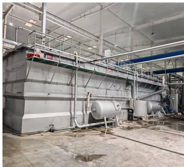
污水处理设施
