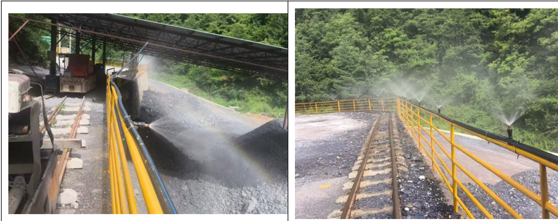
1739m 工业场地原矿堆场及喷淋装置
