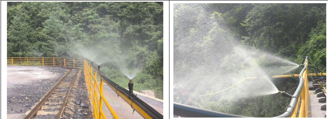
矿石运输道路喷淋装置
