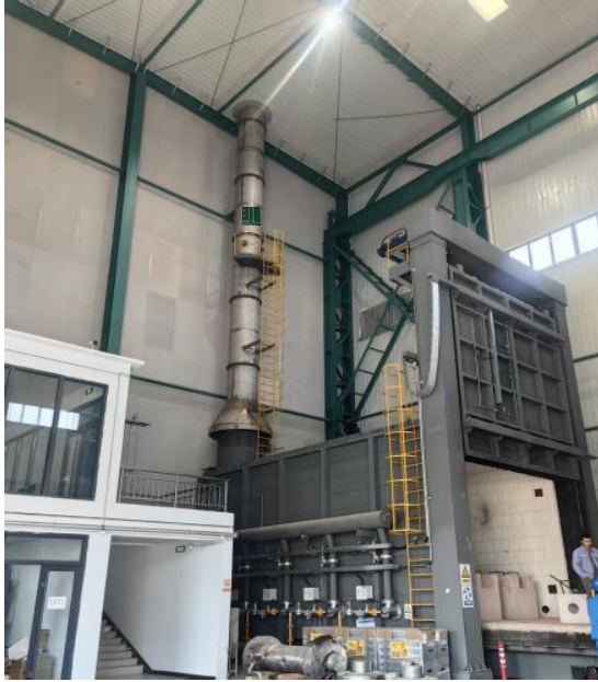
图1 台车式热处理炉排气筒
