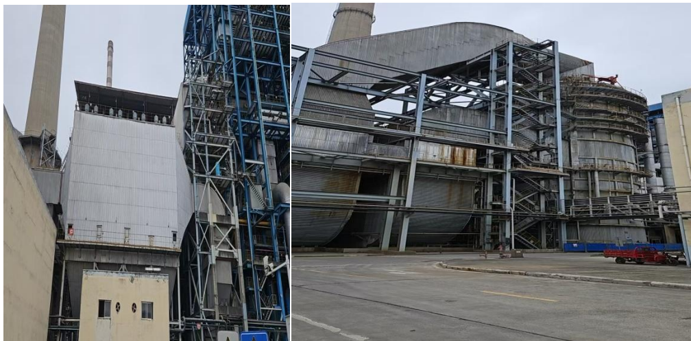
图4-5 锅炉烟气系统 图4-6 锅炉烟气系统
