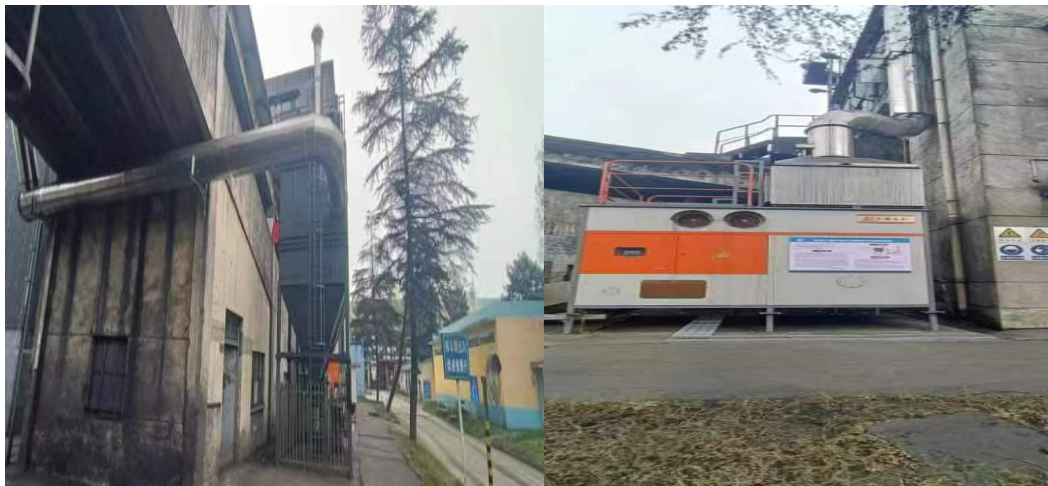
图4-3 应急污泥暂存库布袋除尘器图4-4 应急污泥暂存库脉冲电浆除臭装置
