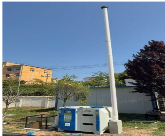
恶臭气体排气筒
