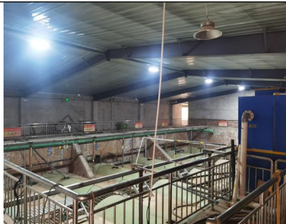
污水处理车间
