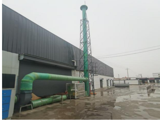
屠宰车间废气处理装置
