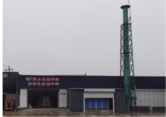
污水处理区废气处理装置
