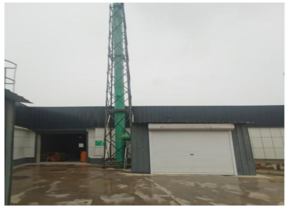
待宰车间废气处理装置
