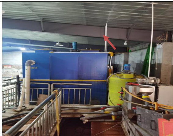
污水处理车间（加药单元）
