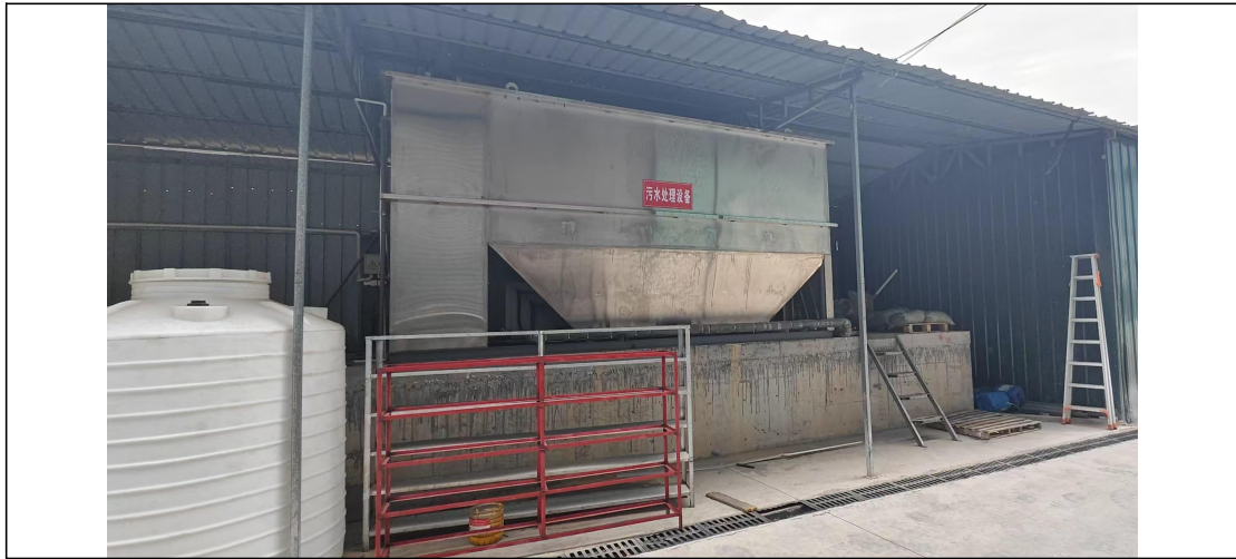
废水治理设施
