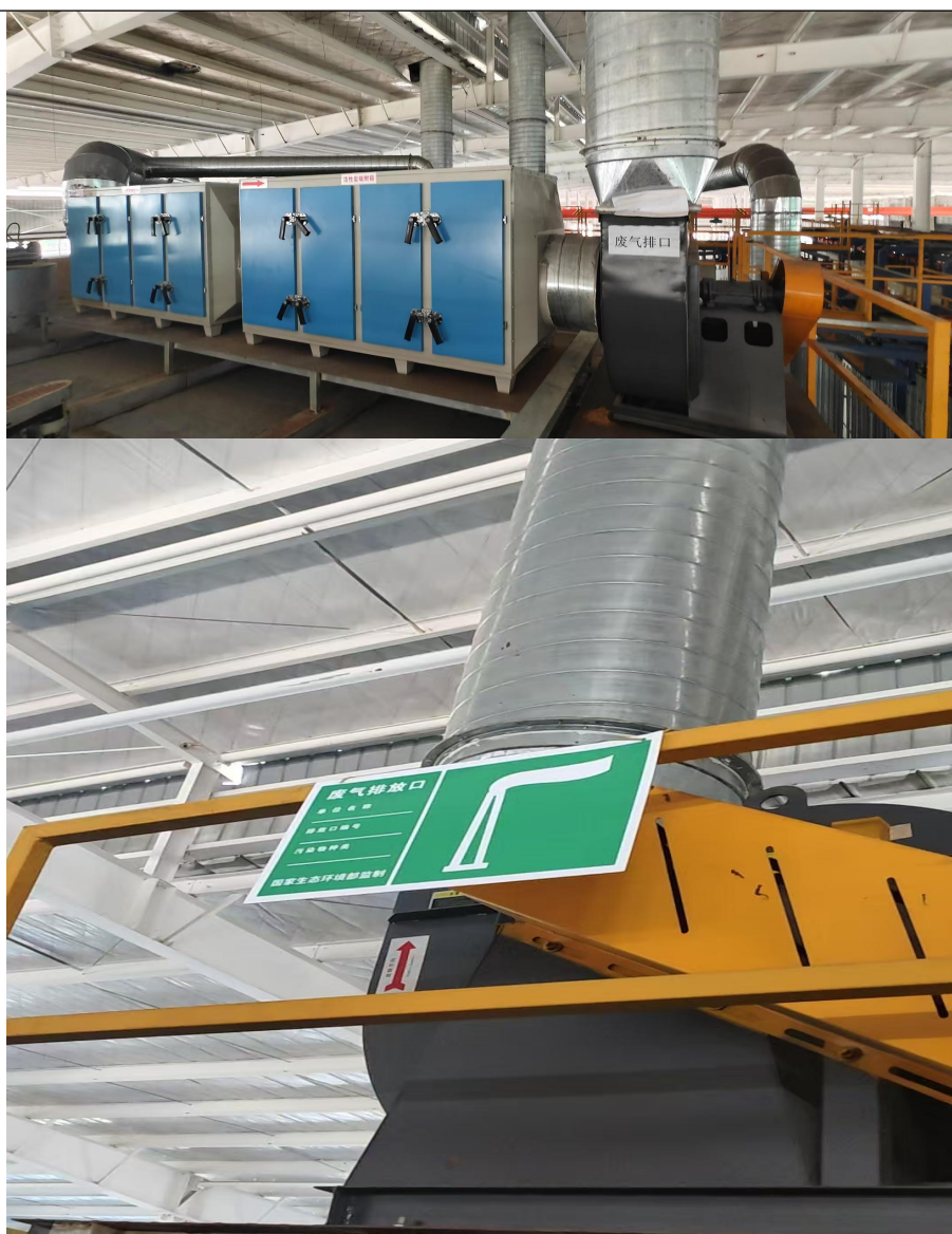
二级活性炭吸附废气治理设施+排气筒及标识牌
