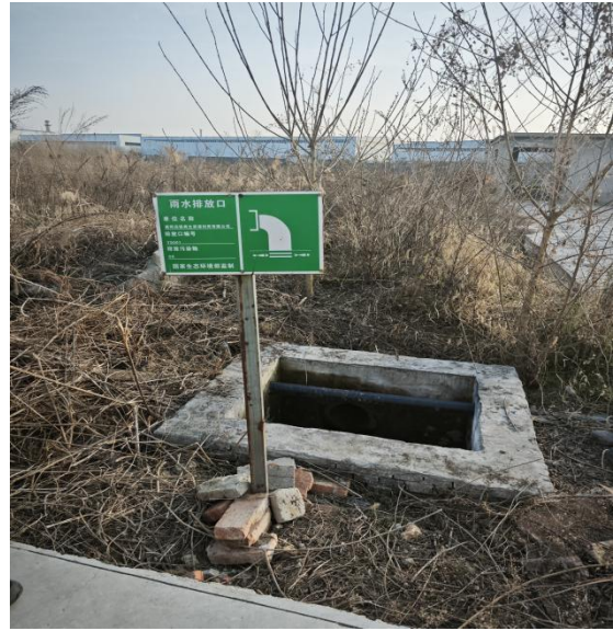
雨水排放口标识牌
