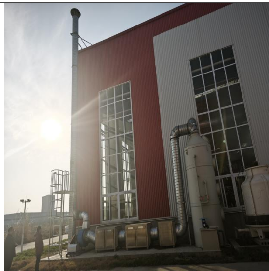
废气治理设施
