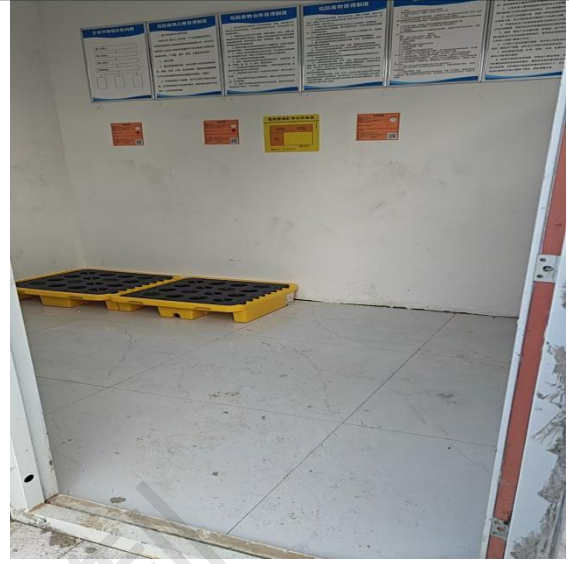
危险废物暂存间内部
