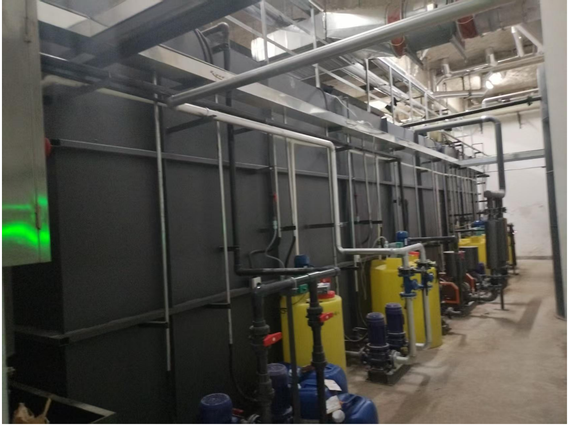
图 7-3 污水处理设施
