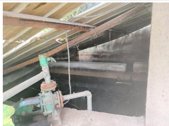
二十四、沉淀池
