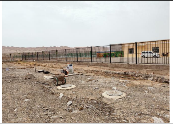
一体化污水处理设施
