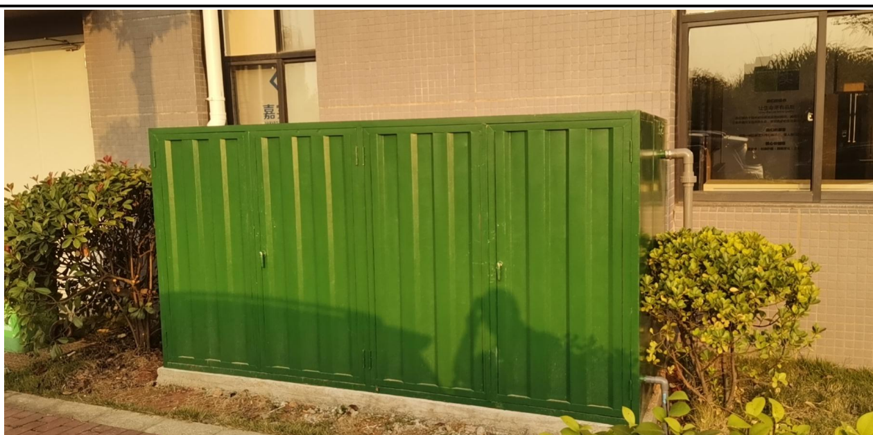
自建污水处理站（新建）
