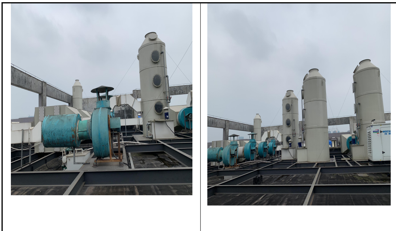
喷淋塔+活性炭吸附装置
