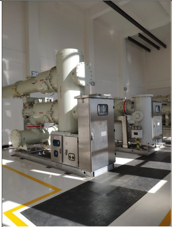
马厂升压站 GIS 室
