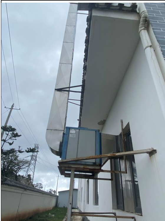
马厂升压站食堂油烟系统
