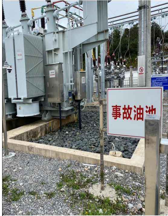
马厂升压站事故油池
