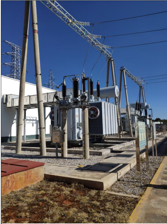
马厂升压站变压器
