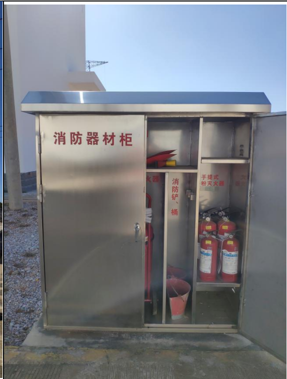
变压器旁消防柜
