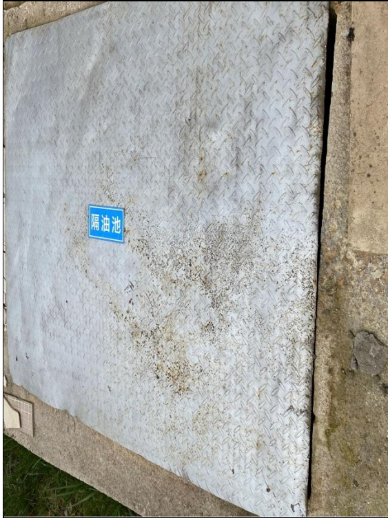
马厂升压站隔油池
