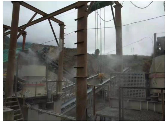
项目生产设备上的喷雾装置
