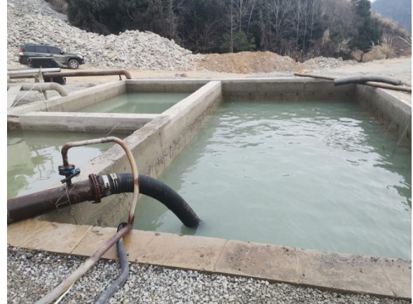
项目废水三级沉淀池
